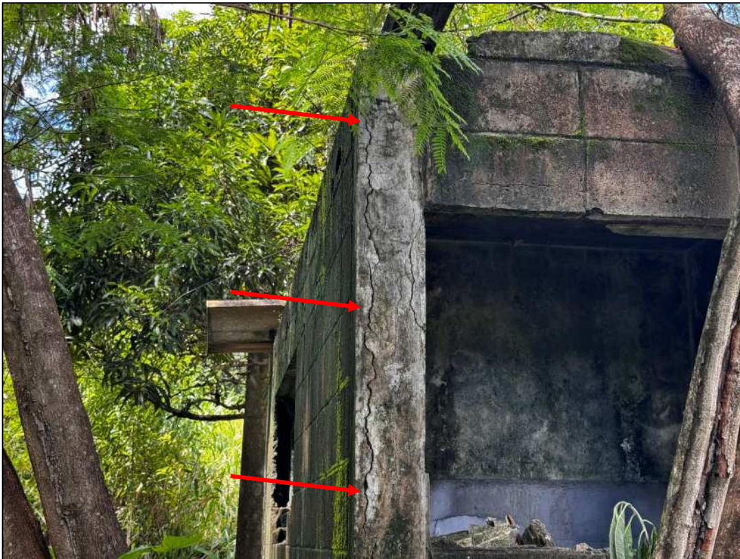
Foto 13 – Vista de trincas no revestimento frontal do bloco.
