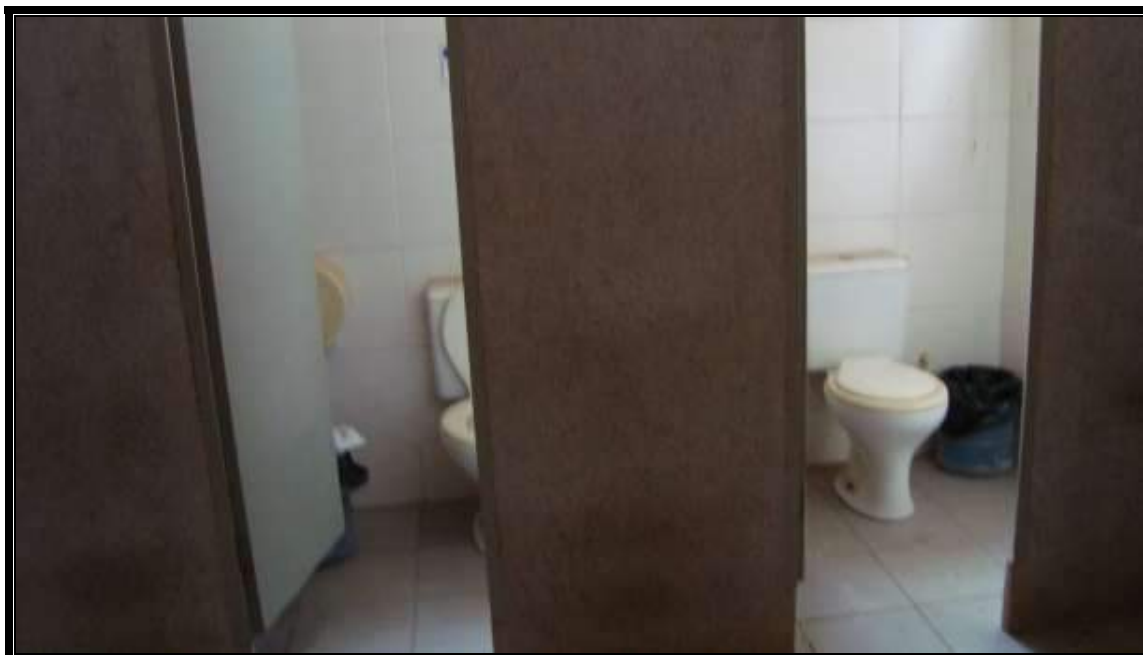
FOTO N.º 15:- Vista do interior dos banheiros do prédio do escritório, onde ilustramos suas características construtivas.
