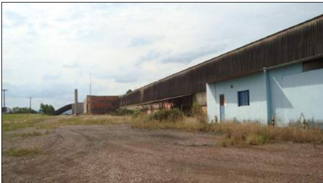
FOTO N.º 03:- Vista do prédio da produção, construído em alvenaria de e do depósito e banheiros construídos em alvenaria com acabamento em tinta látex.
