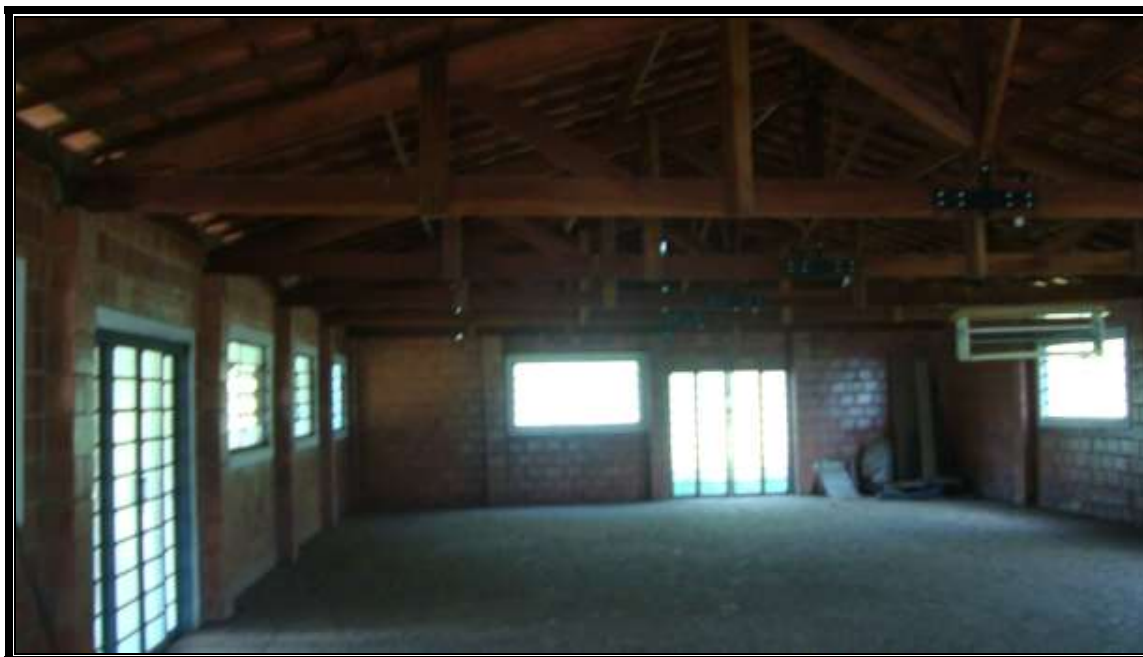
FOTO N.º 17:- Vista interna do salão de festas, onde ilustramos suas características construtivas.
